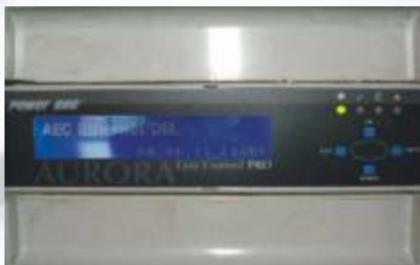
Monitoraggio remoto Aurora dell'impianto fotovoltaico
