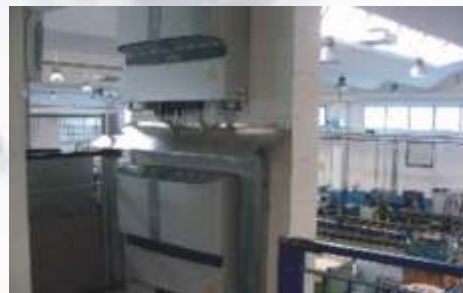
Gruppo inverter Aurora dell'impianto fotovoltaico
